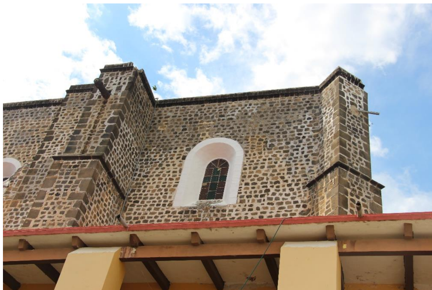
Detalle de los Contrafuertes del ábside del templo. Desde la Casa parroquial.
