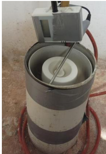
Figura 15. Ventilador y equipo de mediciones al extremo del ducto al interior del módulo de pruebas.
