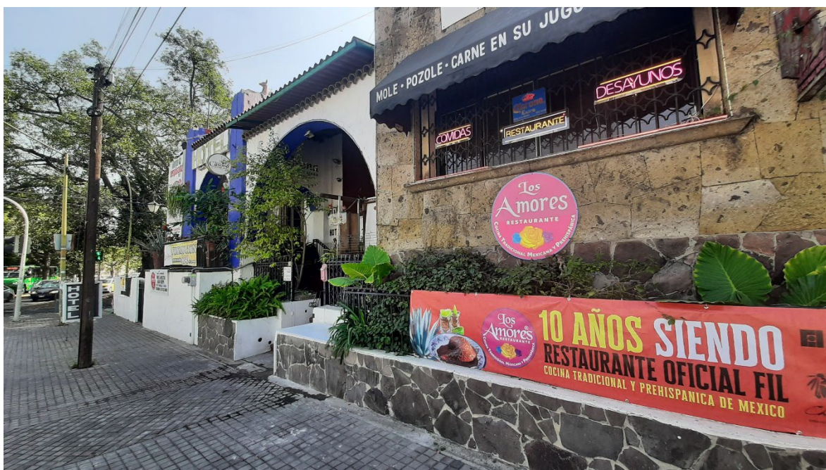
Luis Barragán. Dos Casas para la Familia Robles León en la Calle de López Cotilla severamente afectadas por intervenciones recientes.
