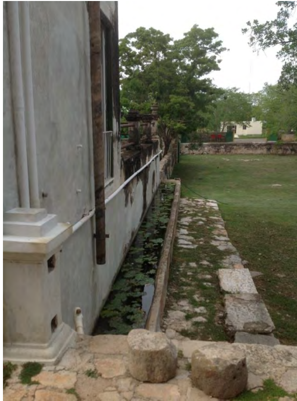
Fig. 48 Canal de recolección de agua pluvial
