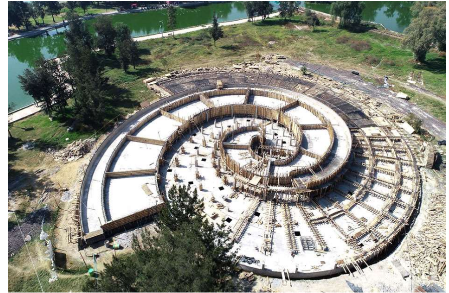
Figura 38. Construcción de un humedal artificial en el Bosque de Aragón. Fuente: https://patronatofq.org.mx/noticias-fq/inauguran-humedal-artificial-en-aragon/
